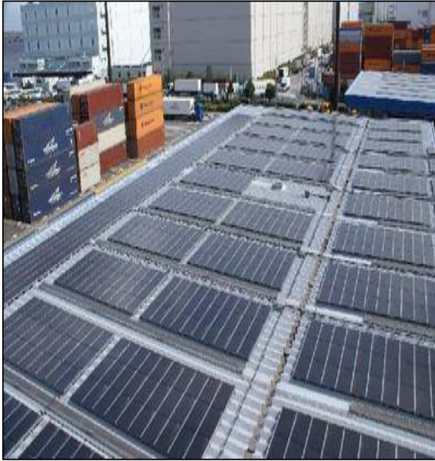
写真-3 太陽光発電システム(日本郵船株HP より)
